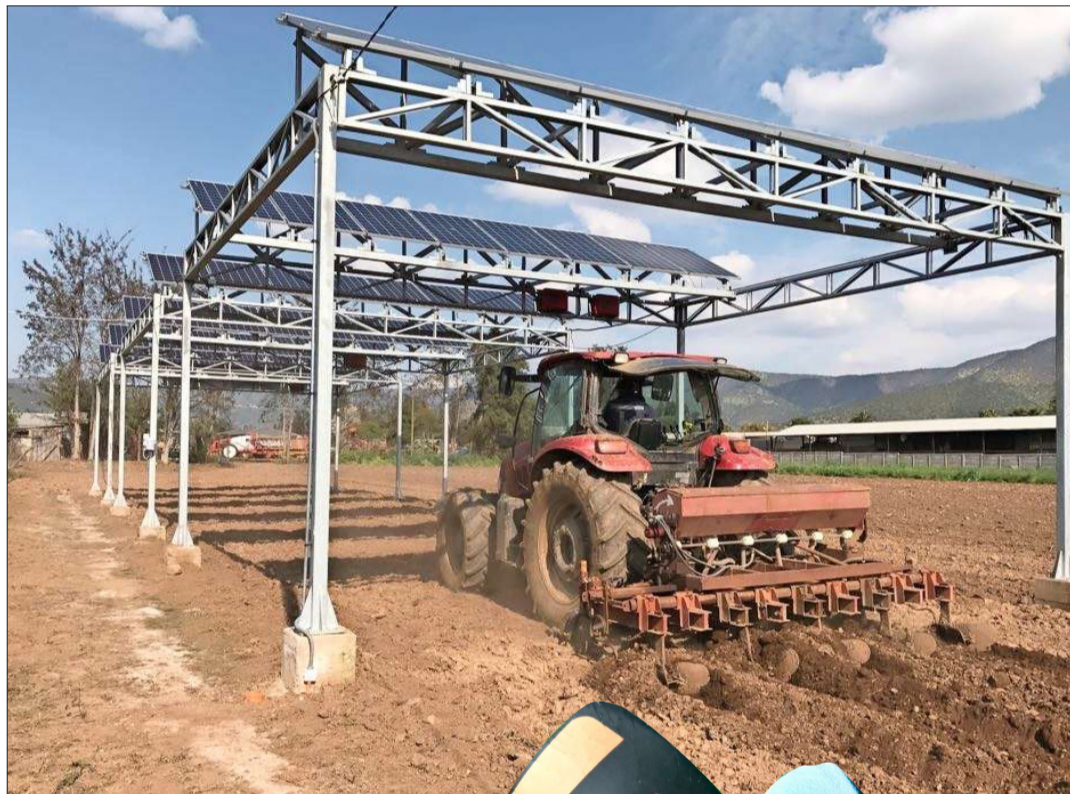
Fraunhofer Chile está probando un piloto, del proyecto AgroPV, donde paneles fotovoltaicos en altura permiten producir energía en los campos de cultivo. En la foto se ve el proceso de arado.
