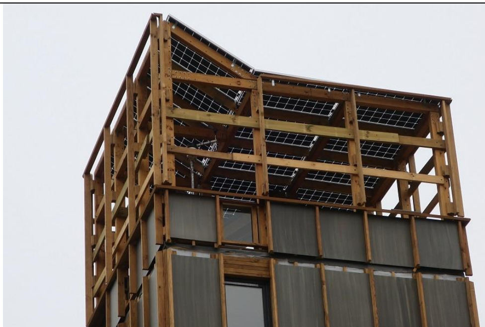
Figura 25 - Fotografía del último piso con los sistemas fotovoltaicos integrados. Fuente: La Tercera
