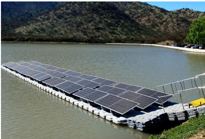
Figura 22 - Piloto FloatingPV, en tranque de la Comunidad de Agua Canal Hospital
